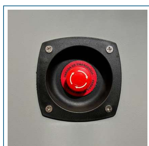
Parada de emergencia externa
