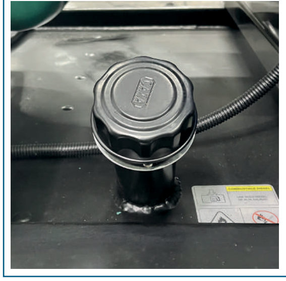
Tanque de combustible
