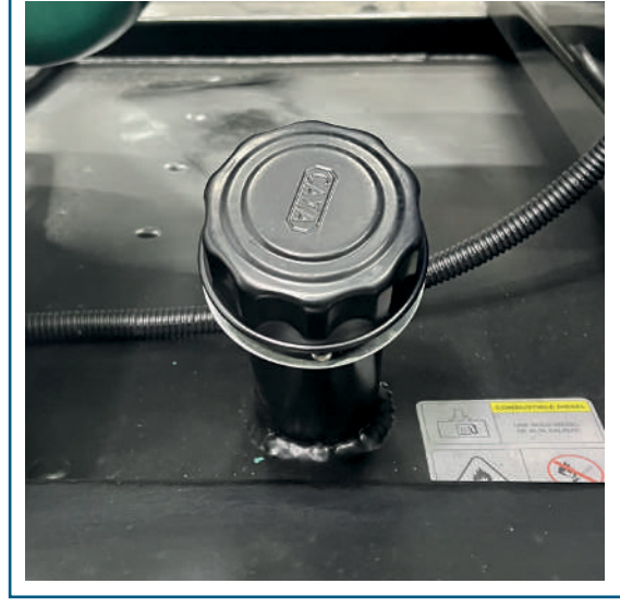
Tanque de combustible
