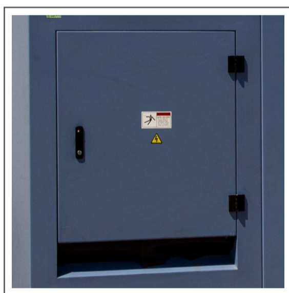
Bornera de conexión
